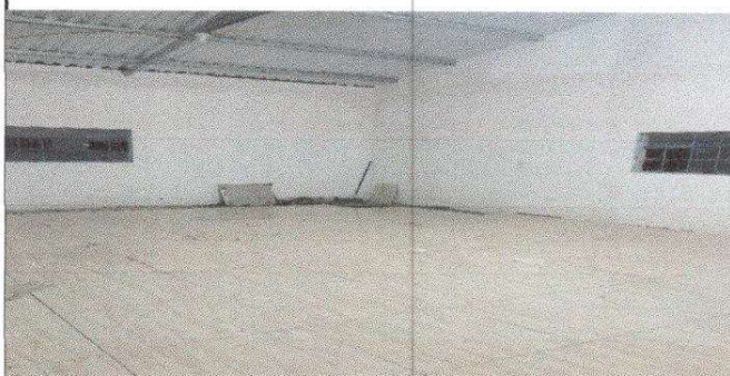
Foto 4: Sustitución de piso de torta de concreto por porcelanato, en la dirección del establecimiento.
